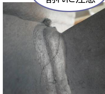
溶接部の割れ
