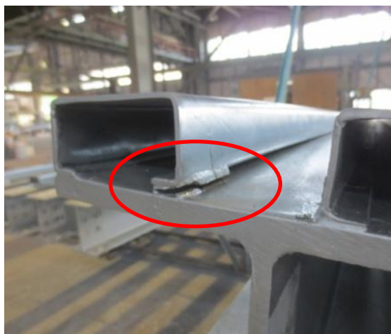
板厚差に起因した溶接割れ
