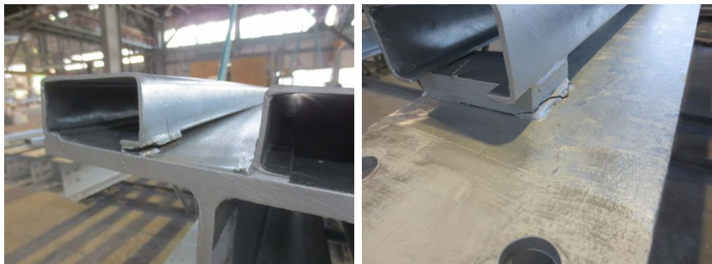
板厚差に起因した溶接割れ
